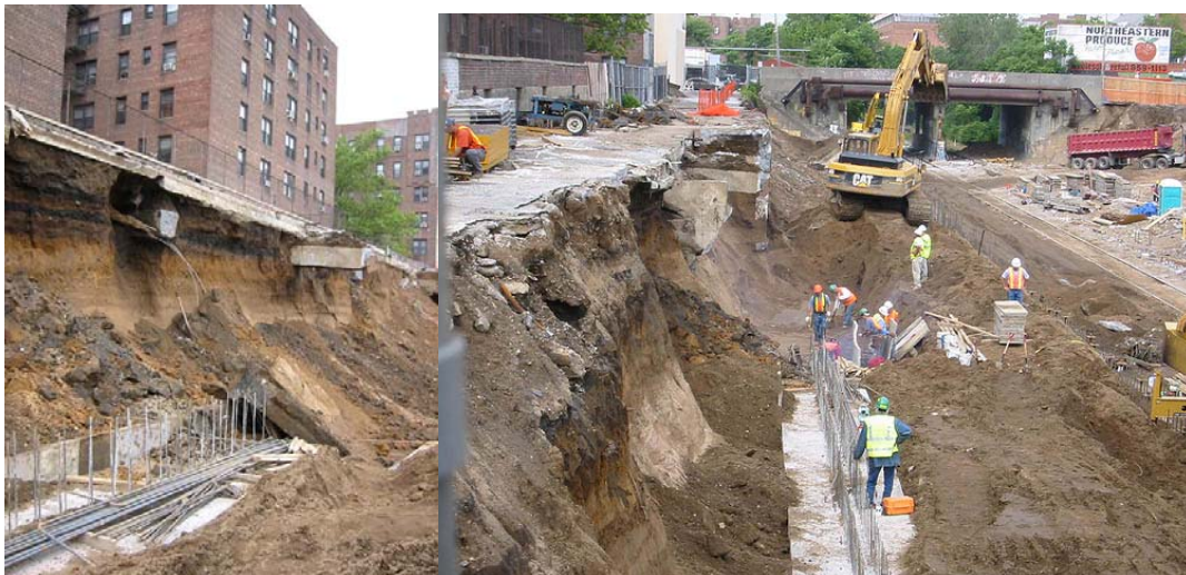
شکل ۱-۴-الف- لحظاتی قبل از ریزش ..... ب- پس از ریزش آوار
