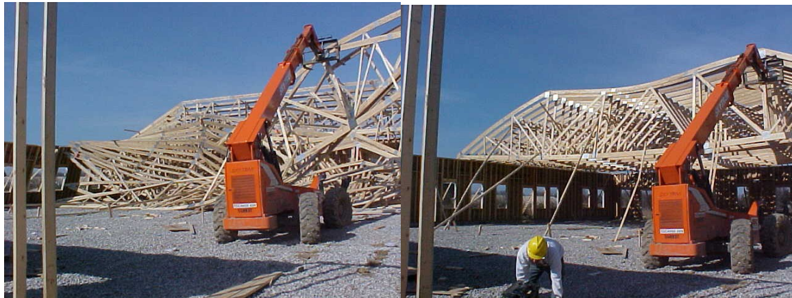
شکل ۱-۵-الف- سقف قبل از نصب.....ب- ریزش سقف
