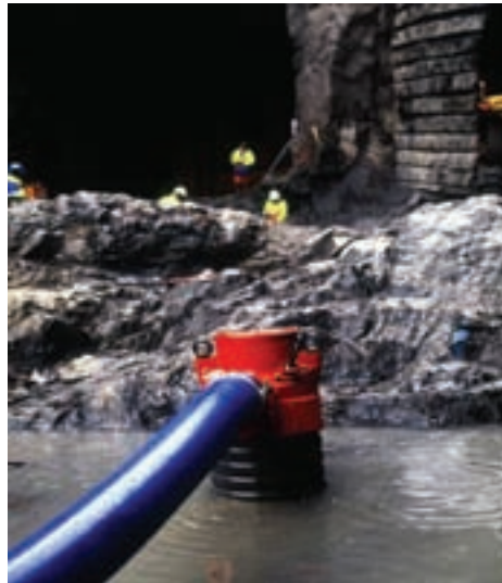
شکل ۱-۳- پمپ زهکش در حال کار
