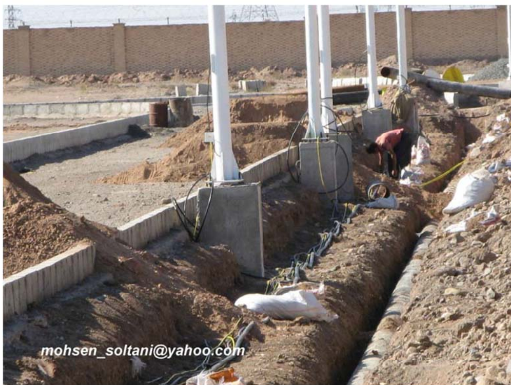
شکل ۲۴_ کابل‌های برق و ارت
