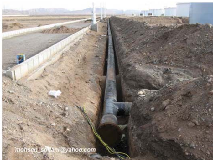
شکل ۵۹- خط لوله آتش نشانی
