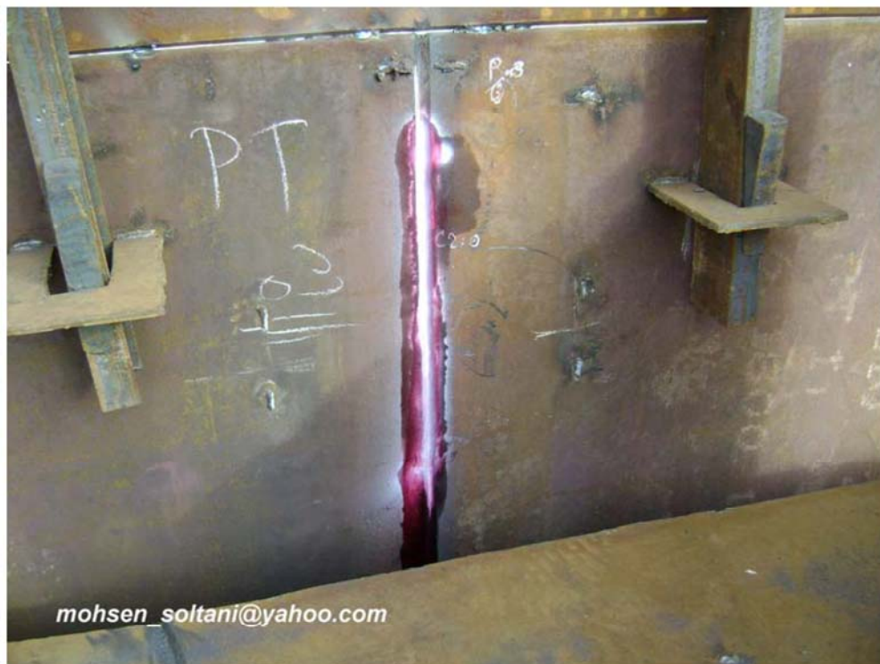
شکل ۲۷_ سطح تست PT
