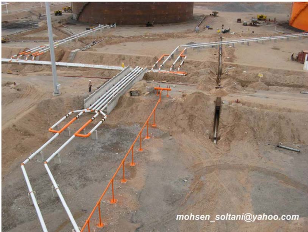
شکل ۶۹- خط لوله سوخت
