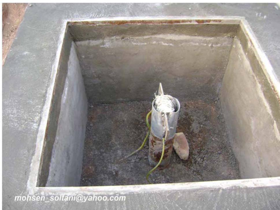
شکل ۲۸_ حوضچه مربوط به چاه سیستم ارتینگ
