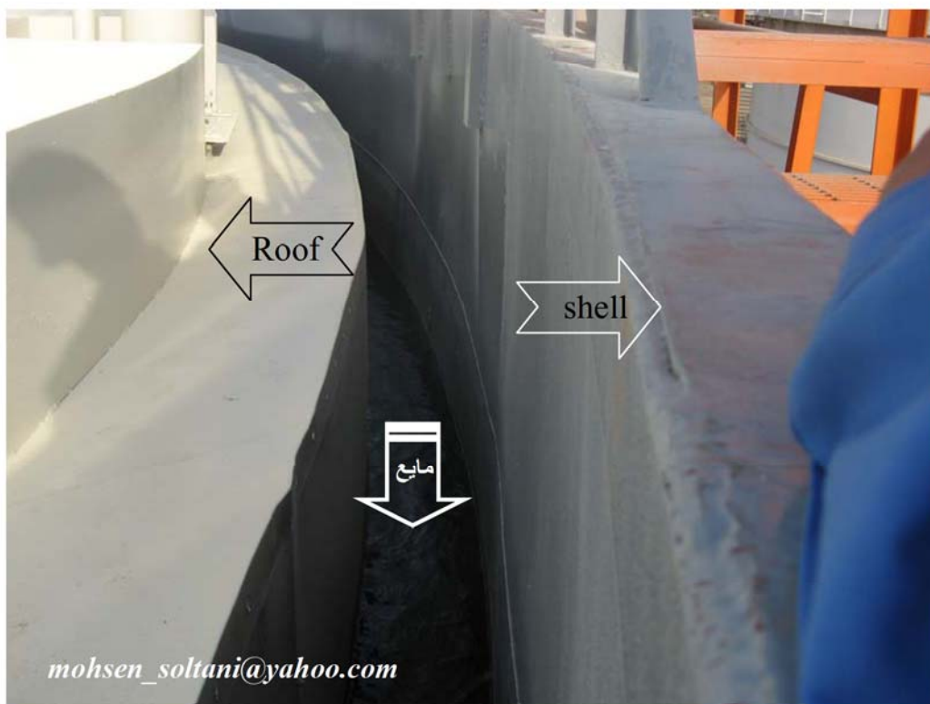
شکل ۵۲- شناور شدن سقف مخزن
