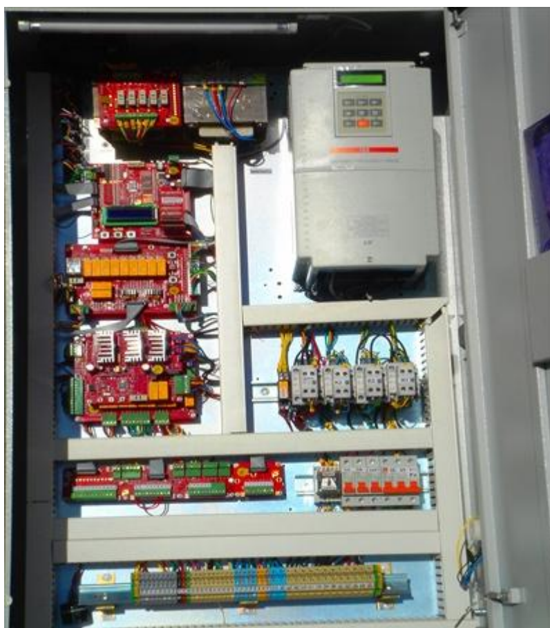
تابلو کنترل موتور MMC
