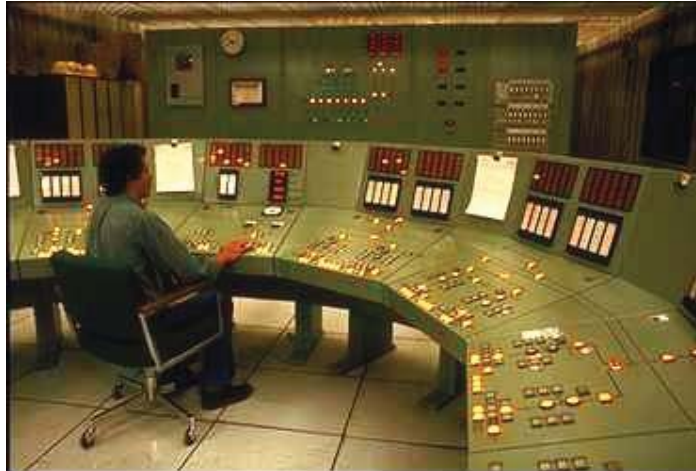
شکل 17-1- اتاق کنترل یک سیستم کنترلی دیجیتال
