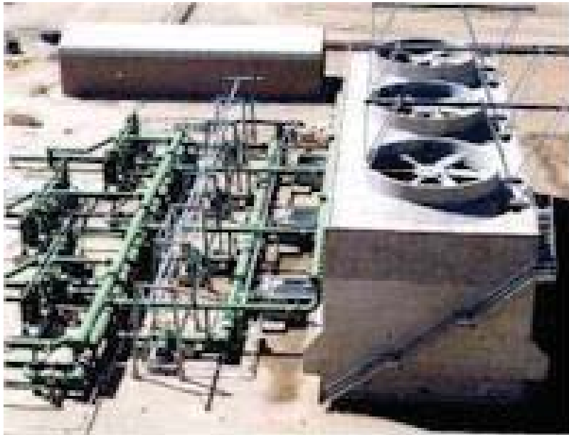
شکل 11-6- تصاویری از Cooling tower های دمنده را نشان می‌دهد
