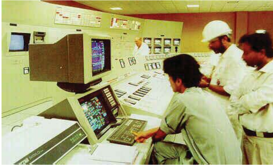
شکل 17-3- اتاق کنترل یک سیستم DCS
