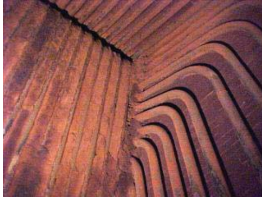
شکل 13-5- دیواره جوش آور، لوله های در معرض شعله
