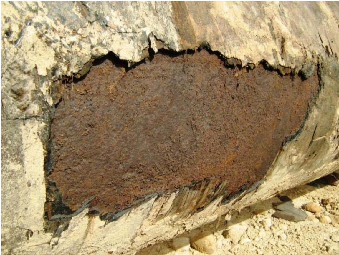
تخریب پوشش قدیمی و بروز خوردگی بدلیل جدایش پوشش از سطح لوله
