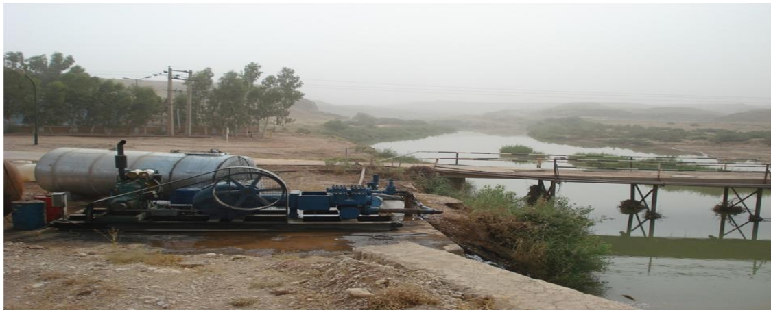
شکل ۴: نمایی از پمپ های نصب شده بر روی رودخانه
