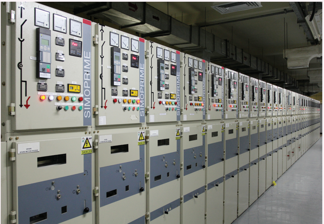
شکل ۶: تابلوهای برق پالایشگاه فازهای ۱۵ و ۱۶ پارس جنوبی
