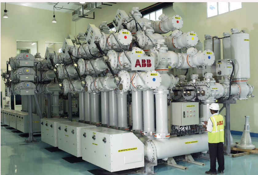
شکل ۱: Substation از نوع GIS به ظرفیت ۲×۵۰۰MVA و ولتاژ ۴۰۰kV ساخت شرکت ABB
