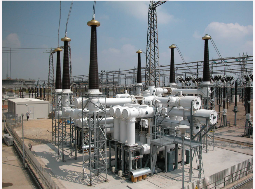
شکل ۸: پست برق از نوع GIS
