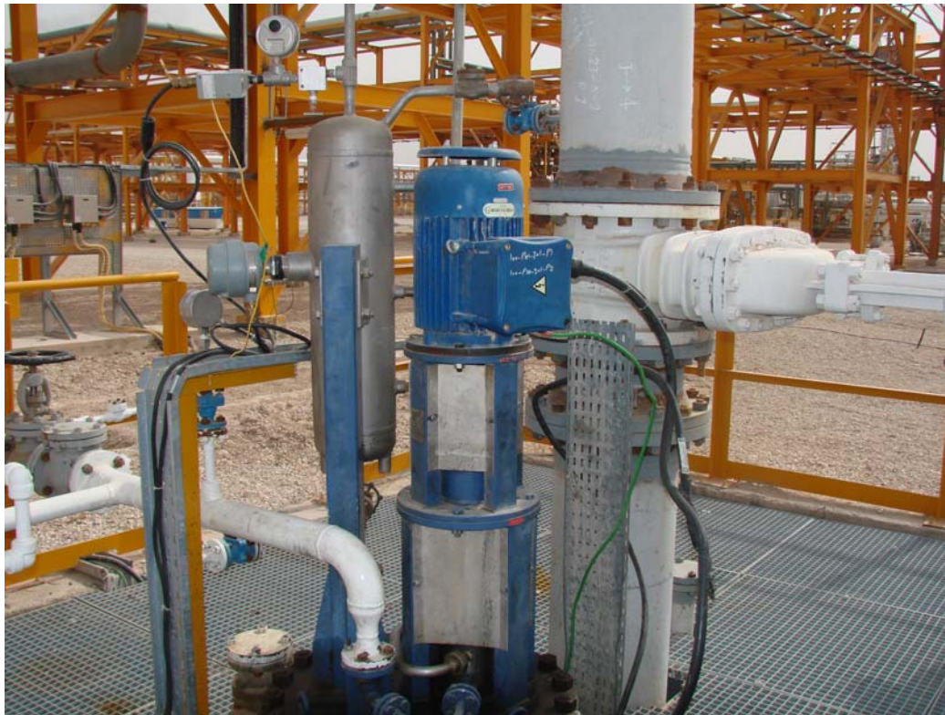
استفاده از Suction Recirculation Line جهت خنک کاری
