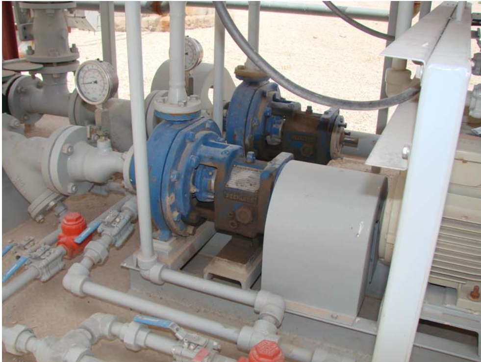
پمپهای یک طبقه
