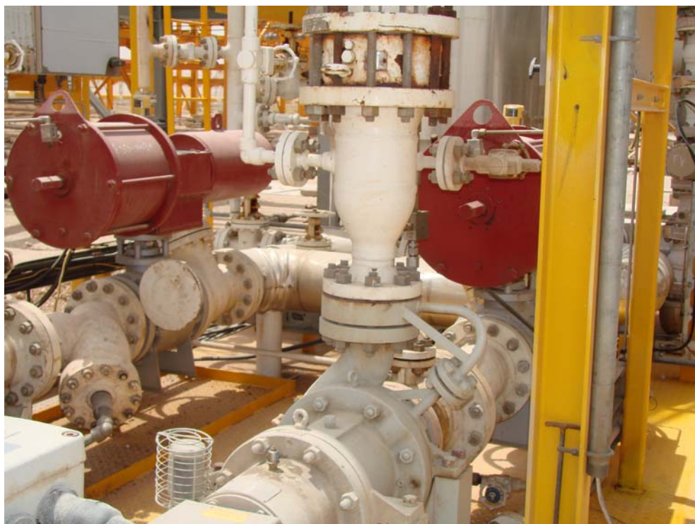
استفاده از Discharge Recirculation Line جهت خنک کاری
