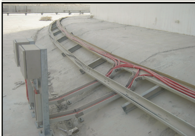
شکل ۳: سیستم اطفای حریق پیشرفته موسوم به Auto Rim Seal System برای مخازن کاندنسیت
