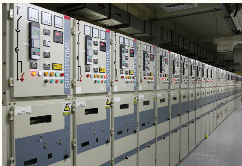
شکل ۱۱: تابلوهای نصب شده در اتاق برق پالایشگاه فازهای ۱۵ و ۱۶
