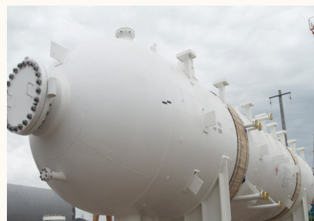
شکل ۸: یک تجهیز ثابت مکانیکی
