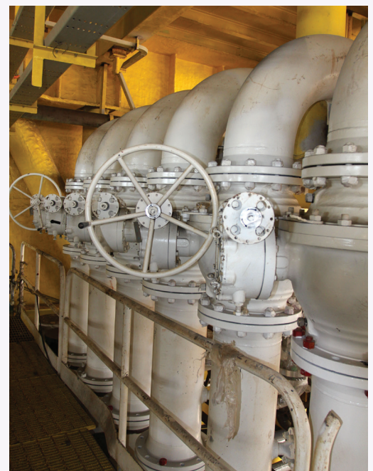
شکل ۹: نمایی از تجهیزات سکو فاز ۱۶
