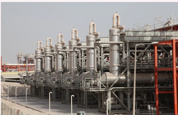
شکل ۶: نمایی از تجهیزات نصب شده در پالایشگاه فازهای ۱۵ و ۱۶ پارس جنوبی
