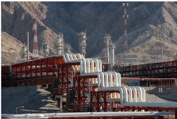
شکل ۵: بزرگراهی چندطبقه از لوله‌های نصب شده در پالایشگاه فازهای ۱۵ و ۱۶
