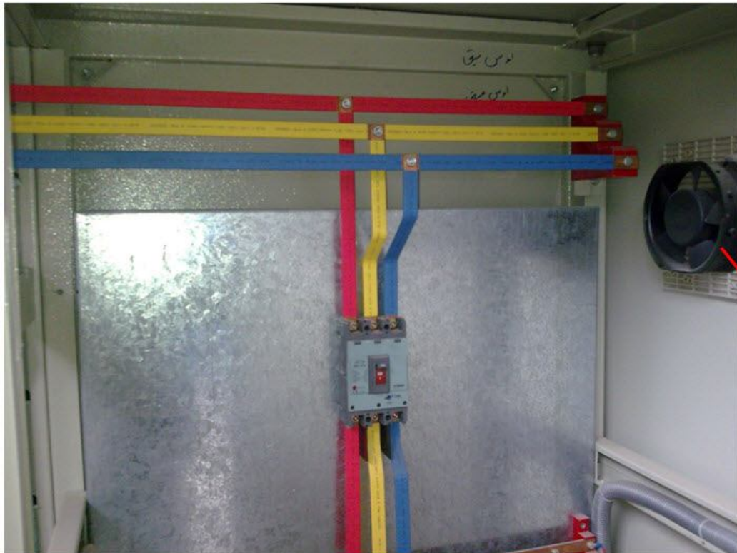
فن تهویه هوای تابلو
